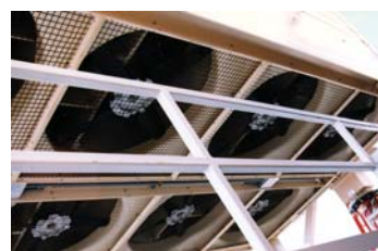
Sistema Mecánico Motor-Ventilador instalados a nivel de piso.
