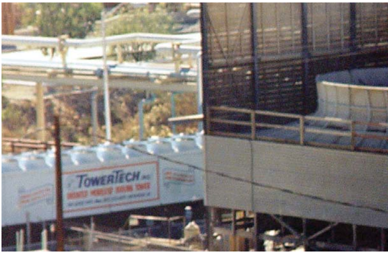
Una de las primeras Torres de enfriamiento MOVILES trabajando.
