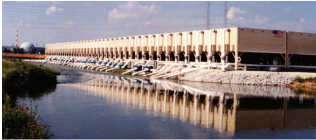
Instalacion de Torres de enfriamiento Modulares reduciendo la contaminación térmica para ComED.
