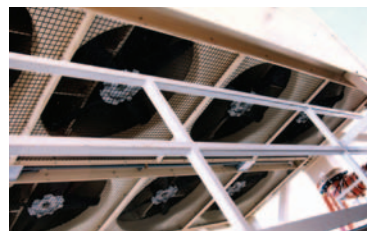
Sistema Mecánico Motor-Ventilador instalados a nivel de piso.
