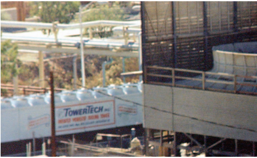
Una de las primeras Torres de enfriamiento MOVILES trabajando.
